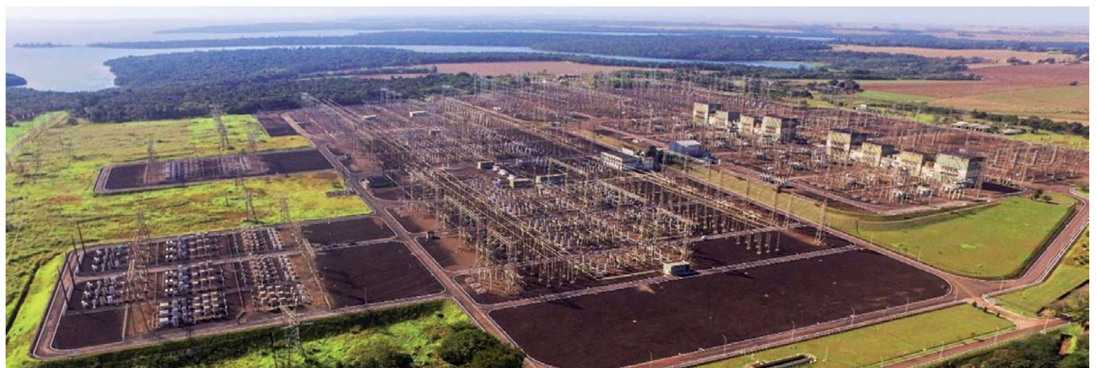
Todo o sistema de Corrente Contínua de Alta Tensão de Furnas será revitalizado
